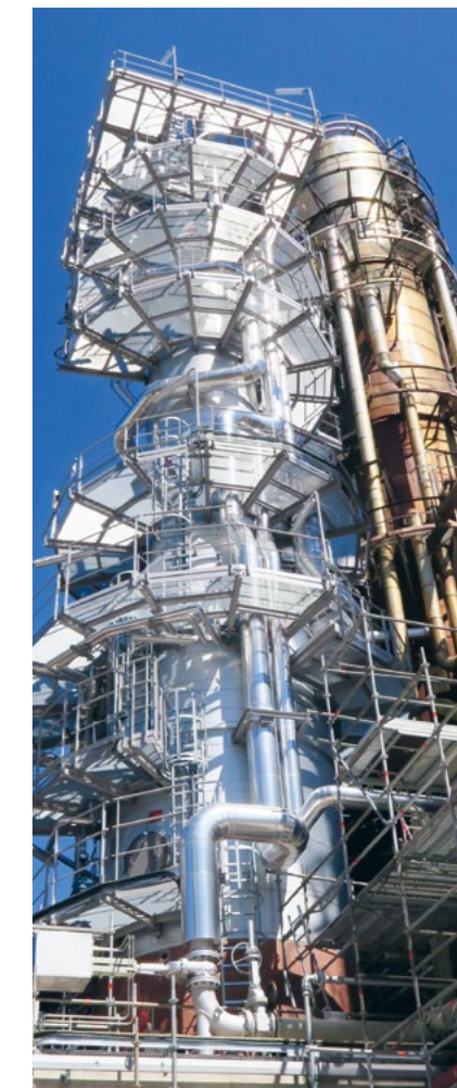
La nouvelle colonne de Pré-flash à Cressier.
